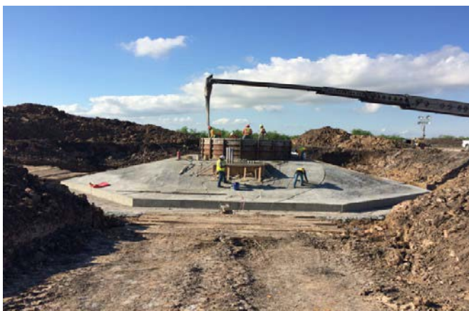
La colocación del concreto para el pedestal de cimentación de la turbina
